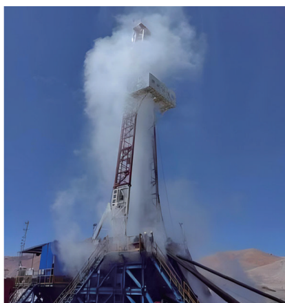
(a)未安装防喷导流装置水汽喷射状况
