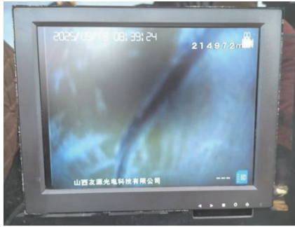
图4 观测井井壁线缆
