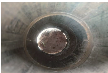
图7 崩刃后未切断的套管内壁
