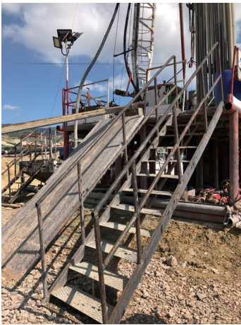
图 4 按 OSHA 标准改造后的扶梯
