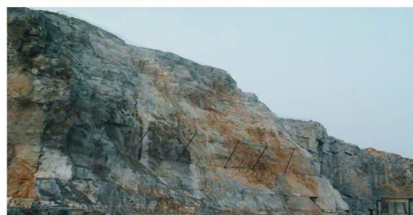
图4 20号治理区段治理前后实景
