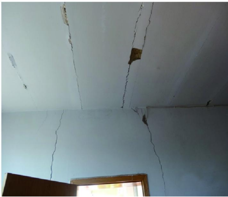
图9 H1 滑坡前缘西侧房屋裂缝
