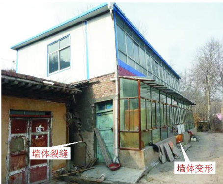
图11 H2 滑坡前缘墙体变形
