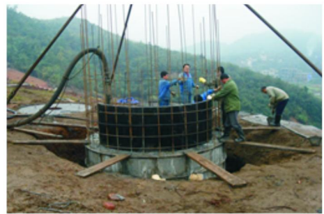
图3 沉井过程中其周边形成了坍塌区域
