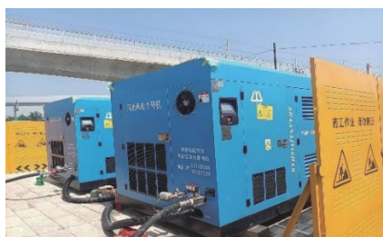
图1 三级电动空压机应用现场
