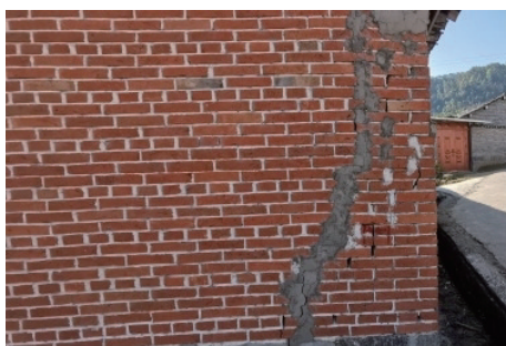
图2 滑坡中部房屋开裂
