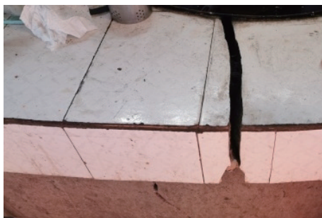
图3 滑坡中部花台开裂
