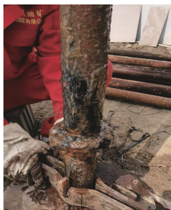
图1 井下锈蚀的井管
