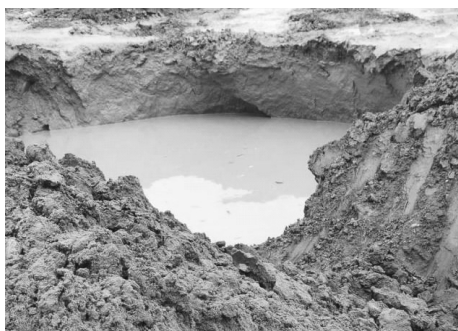
图 1 Z34 号桩孔坍塌情况
