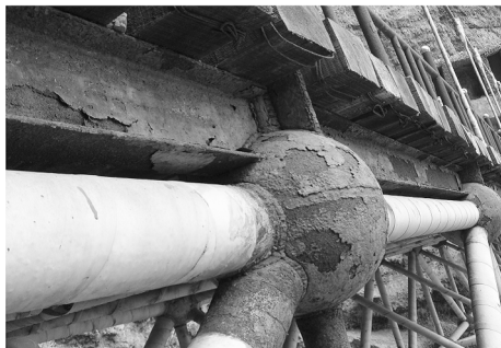
图 2 网架桥锈蚀情况
