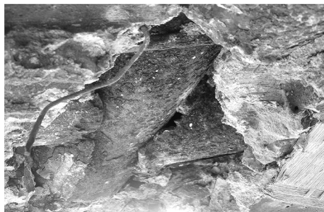
图 3 栈道板底的腐蚀情况
